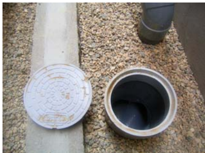
写真-⑮汚水枘（一般部）
